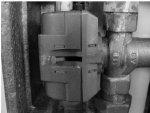
Sání dešťové vody ze sběrné nádrže EP
