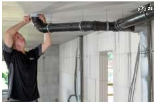
Obrázek 39: Odpadní potrubí s protihlukovým límcem
