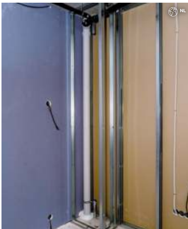
Obrázek 12: Nasucho zděná zeď s upevněním přes konzoly na strop a k podlaze
